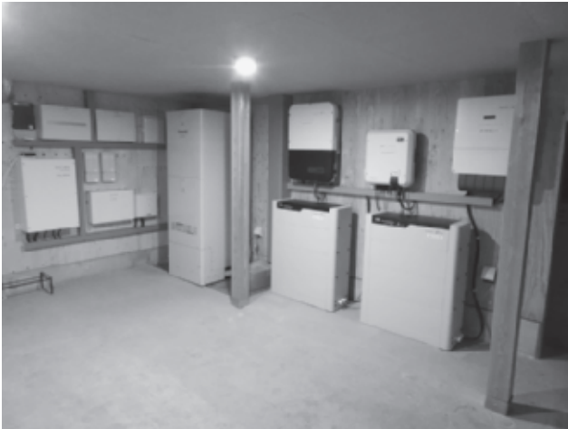
図表8 車庫に備えられた蓄電池やパワコン、自動開閉器など
