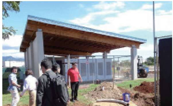
福祉住宅街区のエネルギーセンター。蓄電池・インバーター・非常発電装置などが設置された建物
