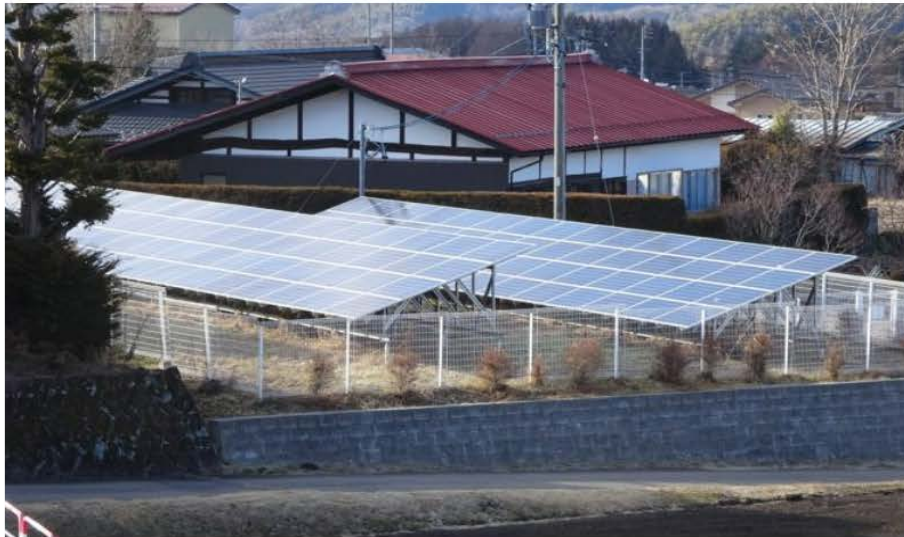
(写真2) 太陽光発電パネル
