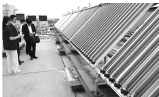
ひがしだクリニック屋上の集熱器、視察者が絶えない
