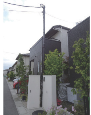
＜写真2＞五つのお宅分の接続箱など
