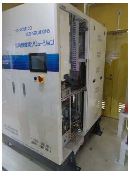
写真 2：米倉山の水素製造設備（筆者撮影）
