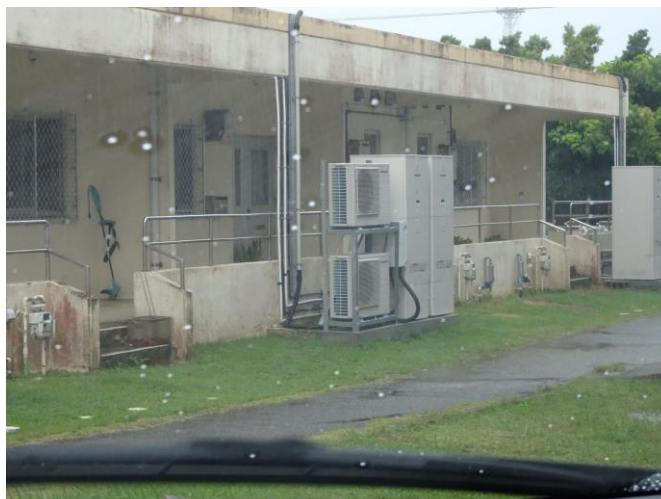
写真3 遠隔操作用 HEMS に対応したエコキュートが設置された市営住宅（筆者撮影）
