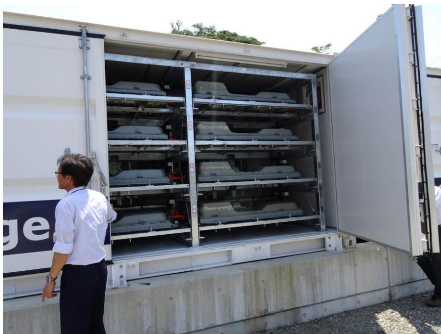
写真 1：中古のリチウム蓄電池群を収めるコンテナ（旧浦内小学校校庭）（筆者撮影）
