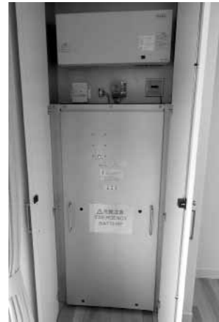
家の片隅に鉛蓄電池ボックスと3電池を制御するパワコンを収納
