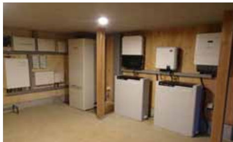
（金山デッキのスマートソーラー社製蓄放電システム）蓄電容量は公称23kWhで、その8割を充放電に使うことができる。発電パネルの能力は8.8kW
