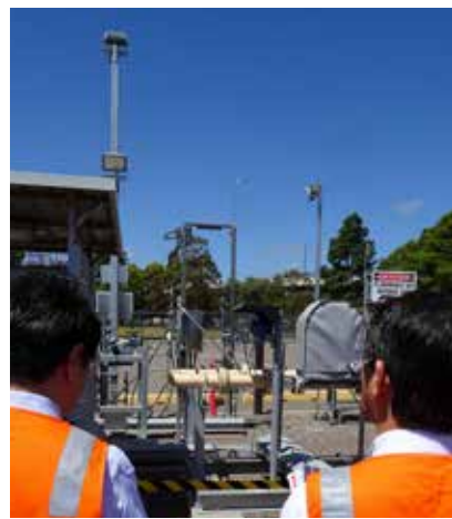
〈写真2〉水素を都市ガスに混ぜる装置
