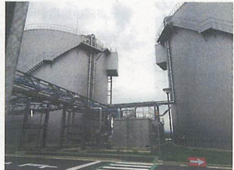
豊橋市中島処理場のメタン発酵タンク
